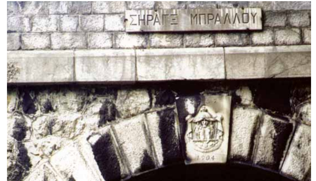
Σ. | Με μήκος 2109μ η σήραγγα του Μπράλλου ήταν, μέχρι πριν λίγα χρόνια, η μεγαλύτερη του ελληνικού σιδηροδρομικού δικτύου. Εδώ, στο κεντρικό σήνηγμα του τόξου της σήραγγας (όψη προς Αθήνα) διακρίνεται ο βασιλικός θυρεός, η επιγραφή «Σ.Π.Δ.Σ.» και το έτος 1904 (συλλογή Ν.Τσίτσα)
